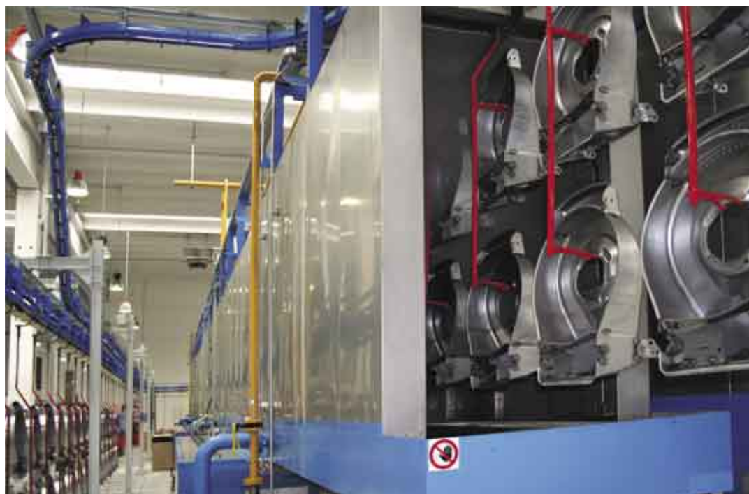
Fig. 8 - Dal carico al tunnel di pretrattamento di conversione con la Bonderite NT1.
