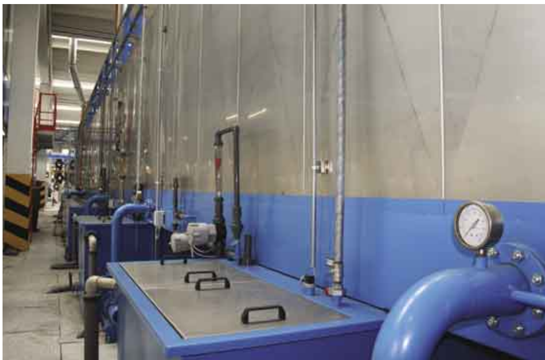
Fig. 16 - Particolare delle vasche di sgrassaggio, risciacquo e trattamento di conversione nanotecnologica.
