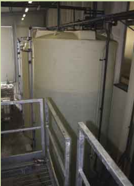
Fig. 24 - I serbatoi di contenimento dei reflui.
