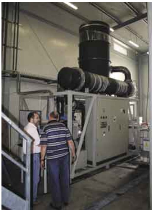
Fig. 9 - Vista parziale dell'impianto di trattamento e recupero delle acque di processo nella fase di evaporazione.
